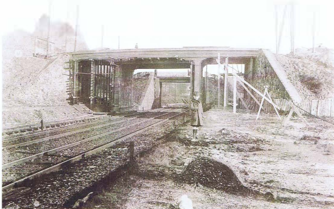
Cette photographie (1) représente la voie ferrée vers l'Est et la gare du Raincy. Elle date de la mise à quatre voies de la ligne vers 1914. Le nouveau pont des « Coquetiers » en construction, enjambant les quatre voies, est au premier plan. En arrière plan, l'ancien pont, à deux voies, sera démoli.
